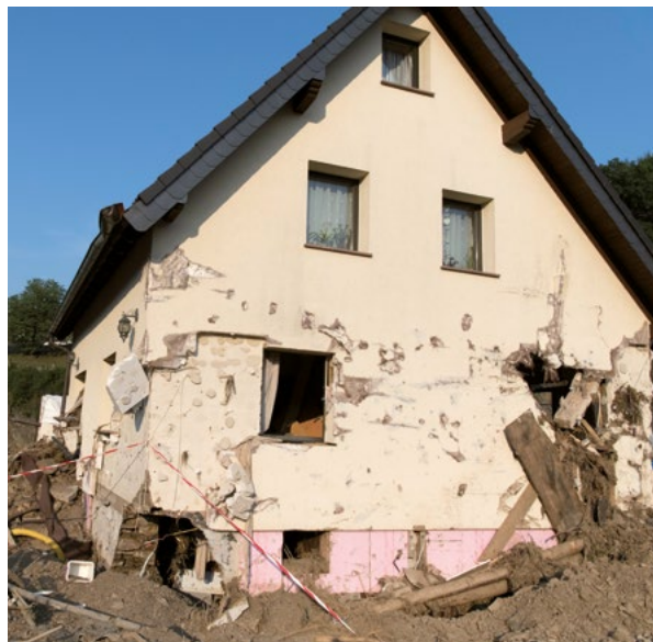
Die Sturzfluten von Tief Bernd haben im Juli 2021 enorme Schäden an Wohngebäuden, Hausrat und Betrieben verursacht. (Foto: © GordonGrand / stock.adobe.com)
