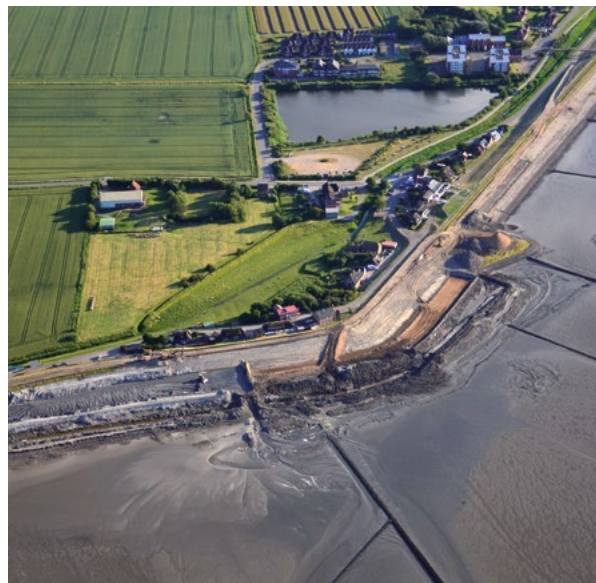
Am Alten Koog auf Nordstrand in Schleswig-Holstein wurden die Deiche verstärkt. Hier wurde bis 2016 der erste Klimadeich errichtet. (Foto: © Lehnerfoto / Generalplan Küstenschutz SH 2022)
